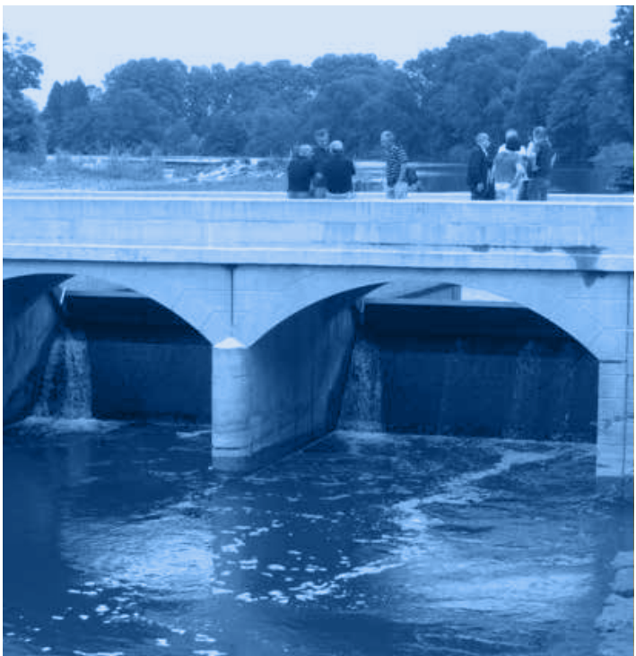
Sortie des turbines hydrauliques ©Adera
