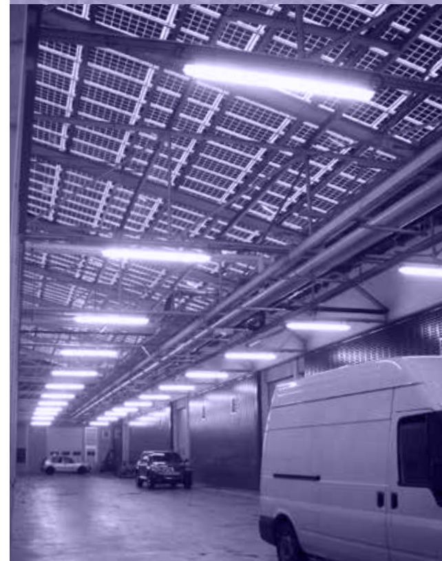
Toit solaire © Ademe
